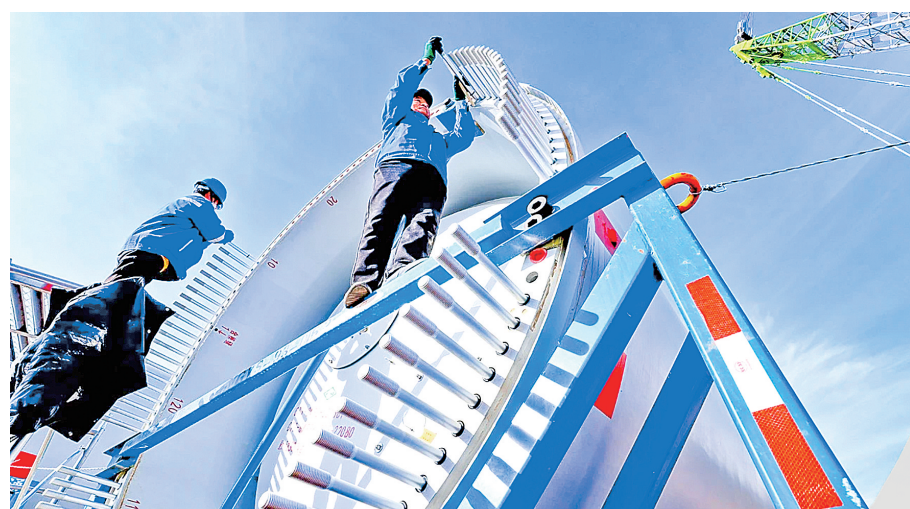
临泽县平川北滩30万千瓦风电项目。
