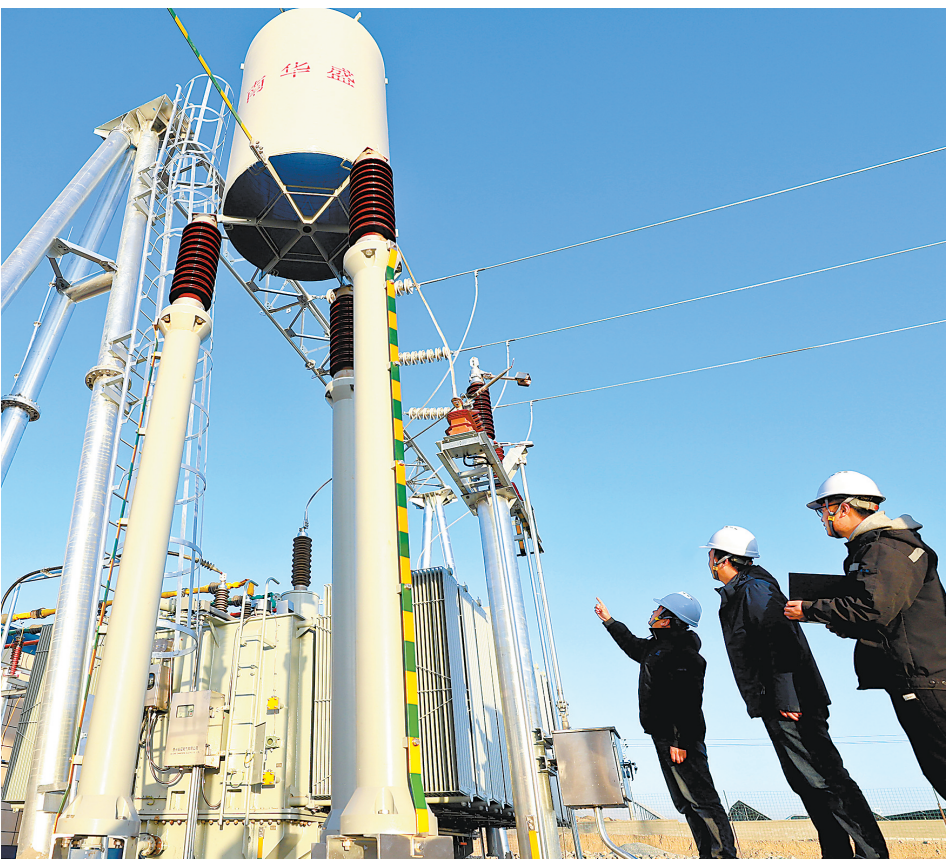
1月16日,在山丹县东乐北滩新能源基地,曦景10万千瓦光伏发电项目正在加紧建设中。 新甘肃·甘肃日报通讯员 王 将 董力玮
