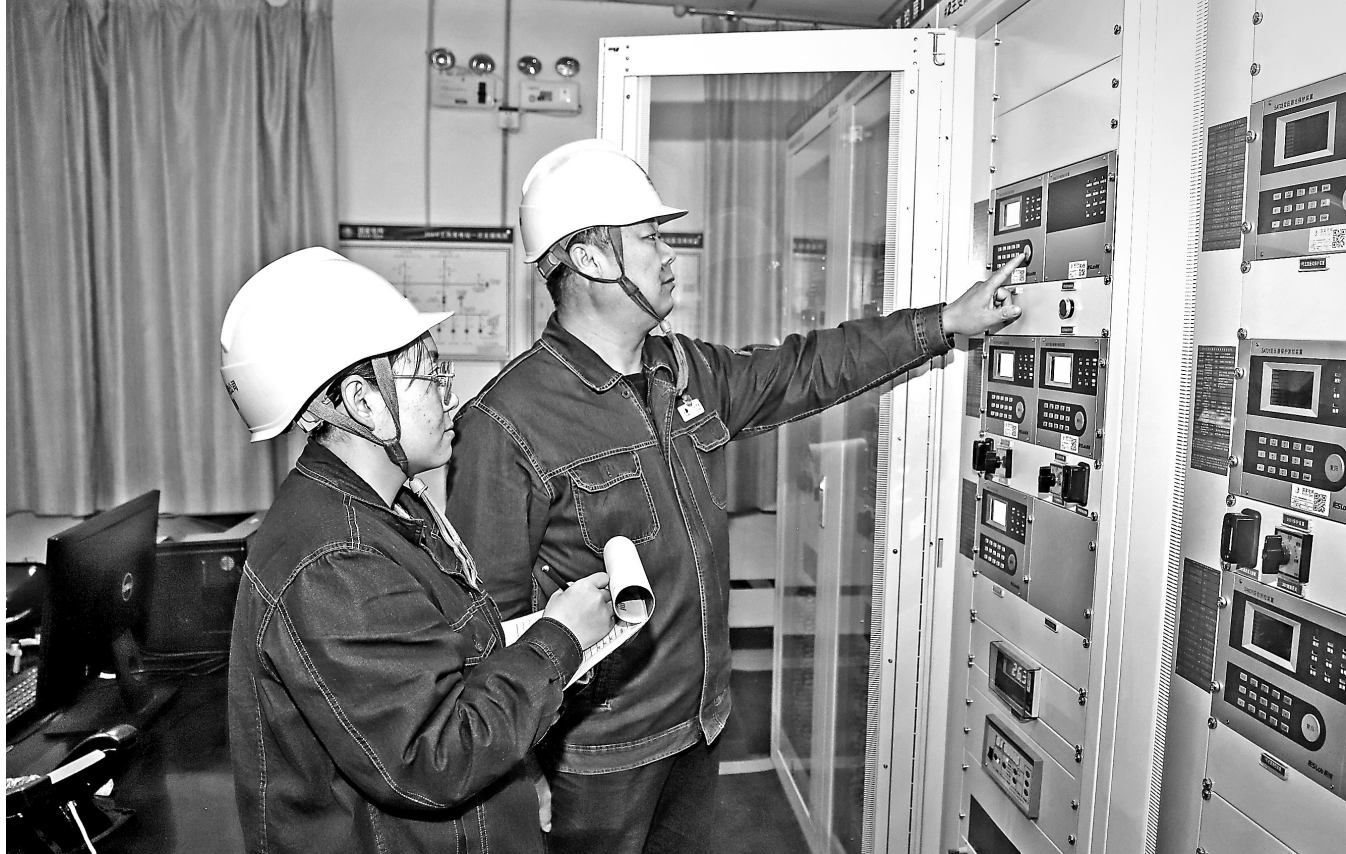
近日,国网金塔供电公司工作人员针对夜间用电负荷增大的情况,对变电站设备进行夜巡,排除隐患保障迎峰度冬期间电网安全。 新甘肃·甘肃日报通讯员 曹红祖
