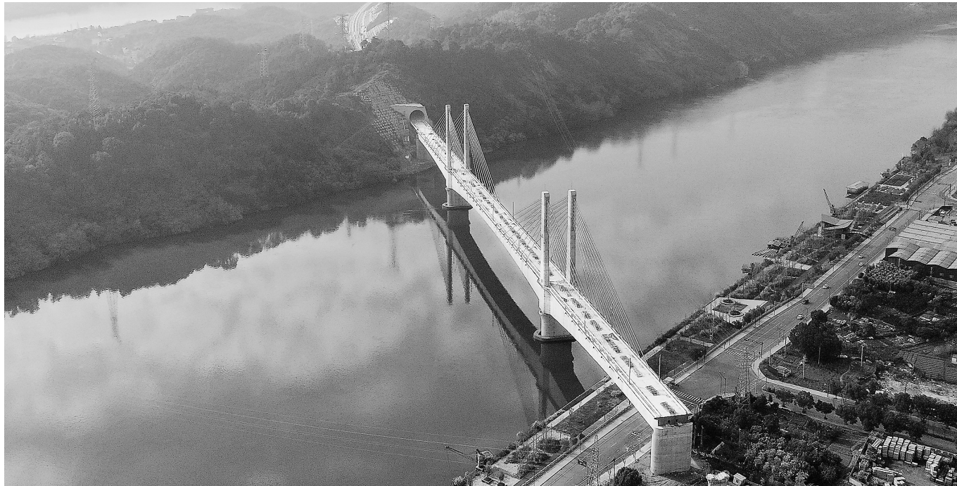
1月6日拍摄的杭甬铁路(建甬段)新安江特大桥及沿线隧道。当日,位于浙江省建德市境内的杭甬铁路(建甬段)外塘吸隧道顺利贯通,至此,全线38座隧道全部贯通,为杭甬铁路开通运营奠定了基础。
