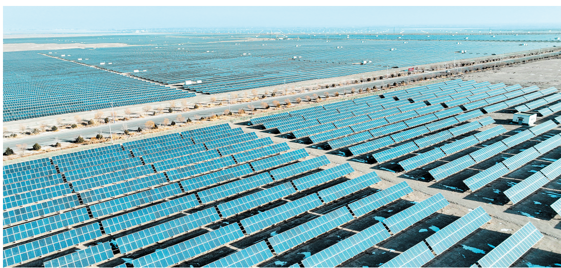
金塔县红柳洼光电产业园内,光伏发电板汇成“蓝色海洋”,为千家万户输送电能。新甘肃·甘肃日报通讯员 曹红祖
