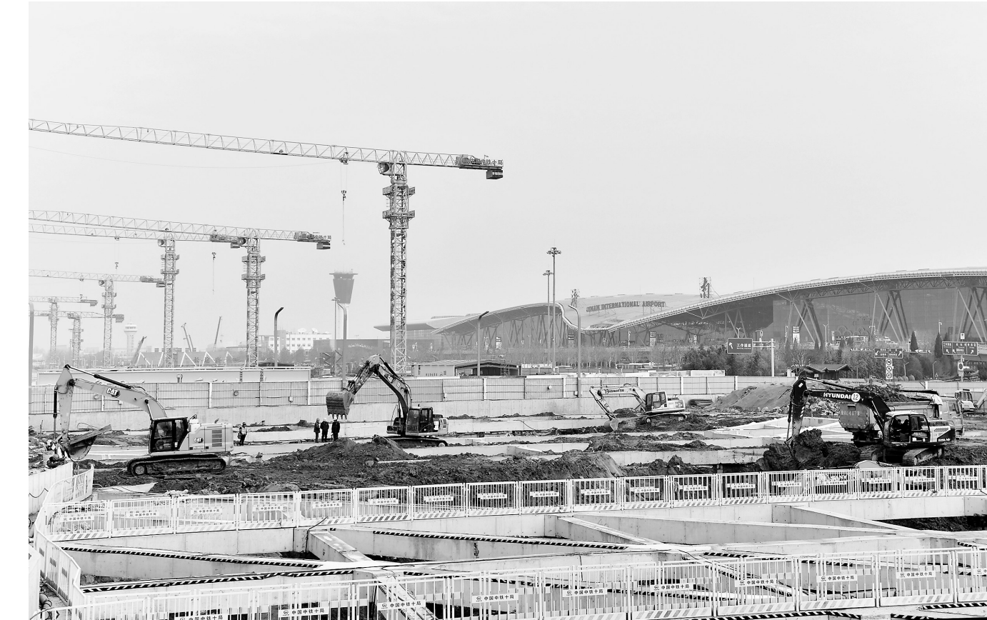
1月2日,在山东济南遥墙机场综合交通枢纽工程施工现场,中铁十局的建设者在进行土方挖掘作业。
