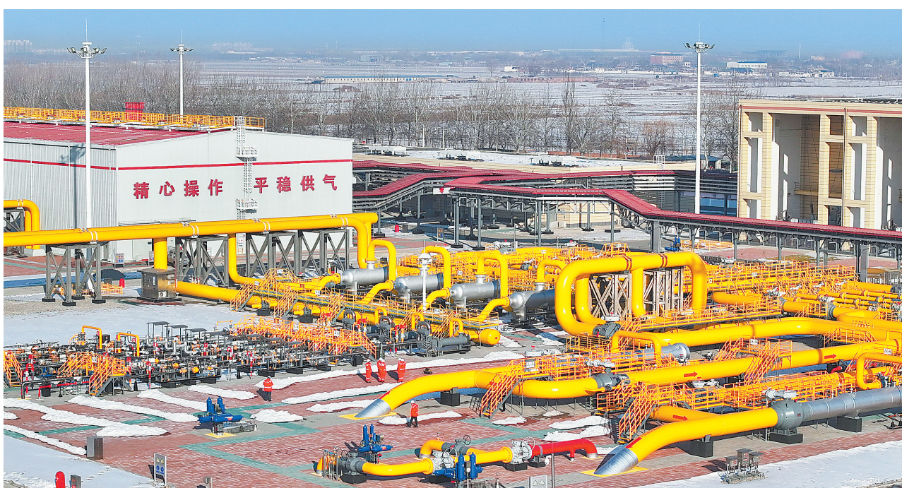
今年入冬以来,位于河北省唐山市丰润区的国家管网唐山联络压气站的工作人员,不断加大天然气管网和机器设备的巡检力度,保证京津冀地区天然气供应。图为12月29日,工人在国家管网唐山联络压气站内工作。 新华社发
