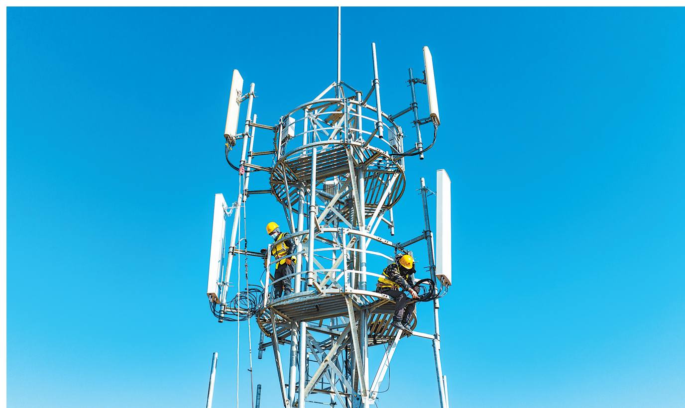
12月28日,中国电信张掖分公司技术人员在张掖市甘州区小满镇康宁村5G基站安装调试设备。近年来,张掖市加大5G网络覆盖力度,全市已建成开通5G基站1200处。
