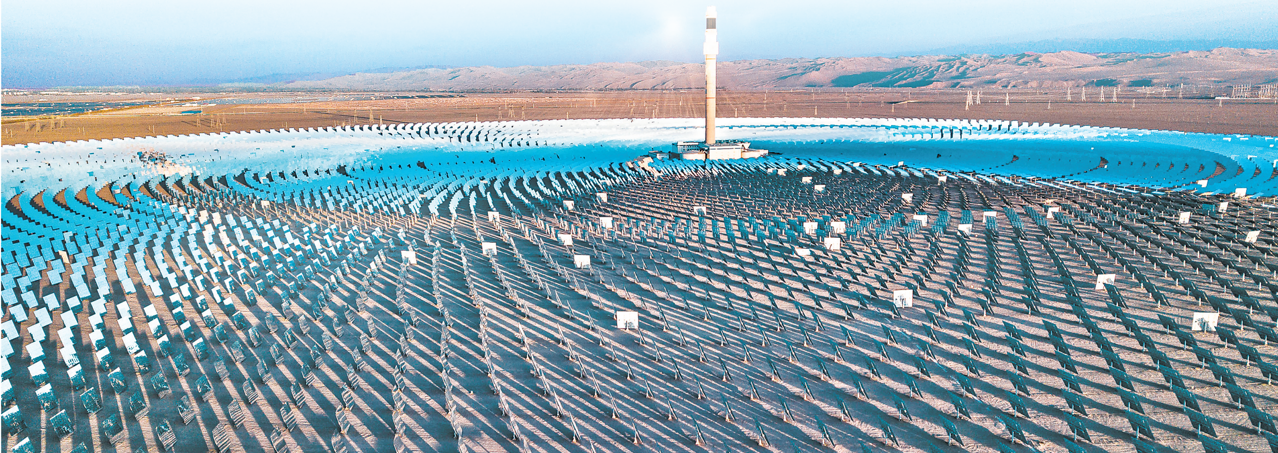
敦煌光电产业园区内熔盐塔式光热发电站万余面定日镜以同心圆状围绕着260米高的熔盐塔逐日发电。
