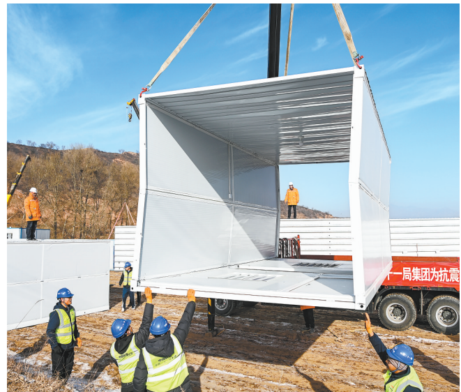
施工人员在积石山县大河家镇梅坡村搭建活动板房。 新甘肃·甘肃日报记者 丁凯
