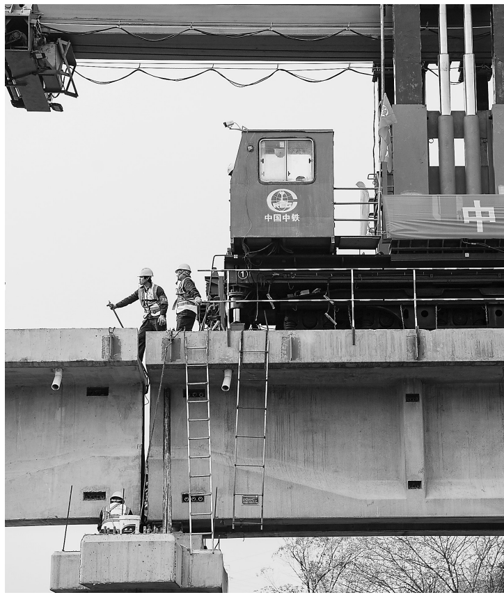
12月21日,位于四川省泸州市境内的隆黄铁路隆叙段铺架工程正式启动。图为工人配合机械进行架梁作业。 新华社发
