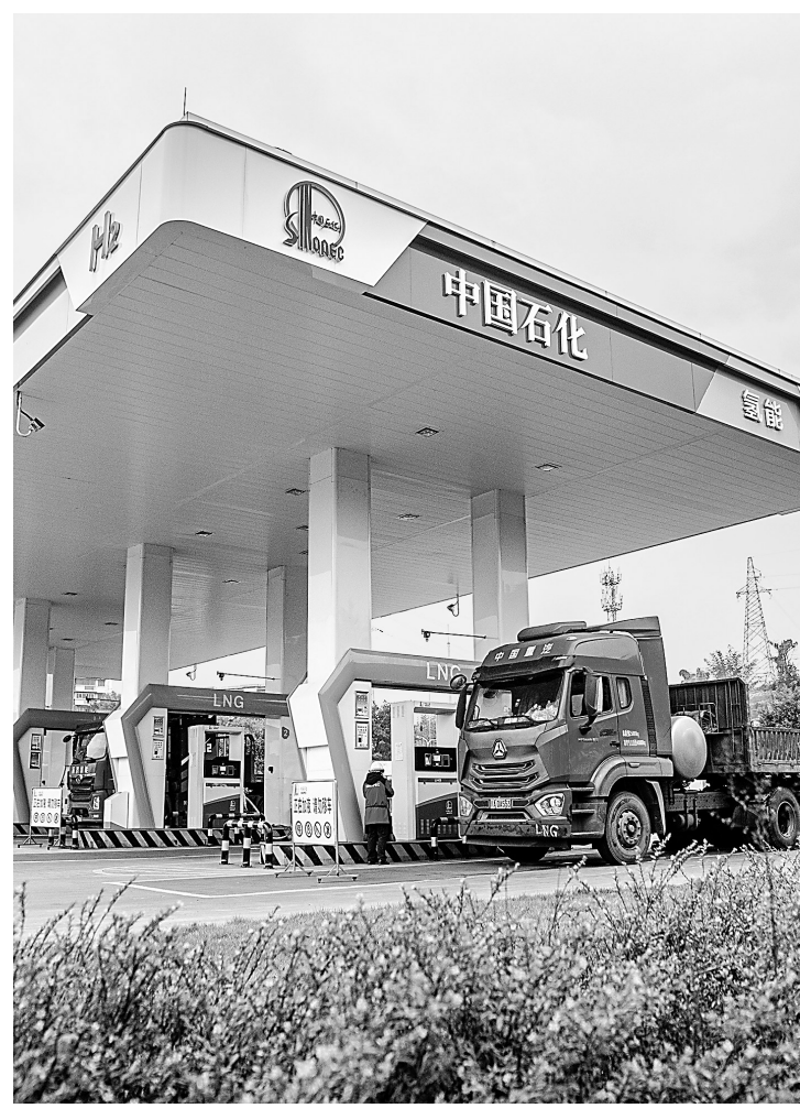
12月20日,我国西南地区最大的车用氢气供氢中心——3000标准立方米/小时氢燃料电池供氢加氢项目在重庆市长寿区建成投运。新华社发
