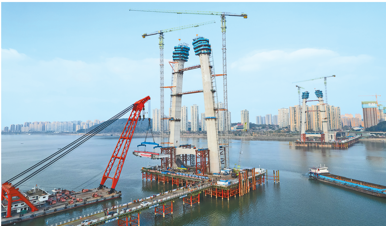
这是12月12日在长沙兴联路大通道项目拍摄的双塔斜拉桥首段主梁架设施工现场(无人机照片)。当日,由中交一公局承建的长沙兴联路大通道项目双塔斜拉桥首段主梁顺利架设完成。项目建成后将缓解长沙北二环交通压力,同时也将成为益阳、常德、张家界等城市进入长沙的重要通道之一。
