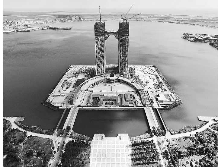
近日,位于中国(上海)自由贸易试验区临港新片区的临港西岛中银金融中心项目建设取得新进展,南北两座塔楼成功“牵手”。据悉,中心建成后将成为以金融总部办公为主体的大型城市综合体。
