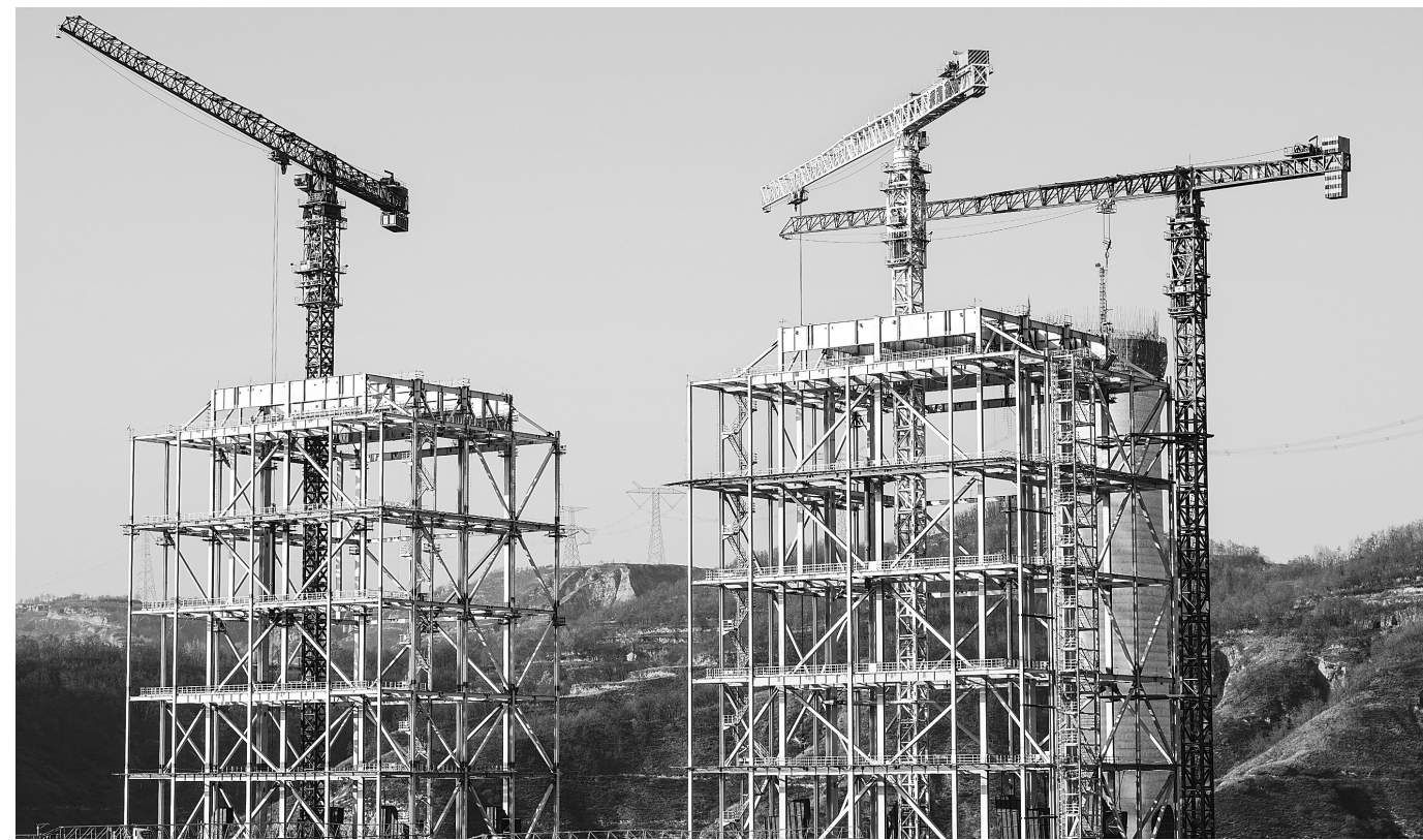
近日,灵台电厂建设现场,施工人员进行吊装、混凝土浇灌等作业。灵台电厂总投资78.23亿元,计划2024年底建成投产。新甘肃·甘肃日报通讯员 王晗
