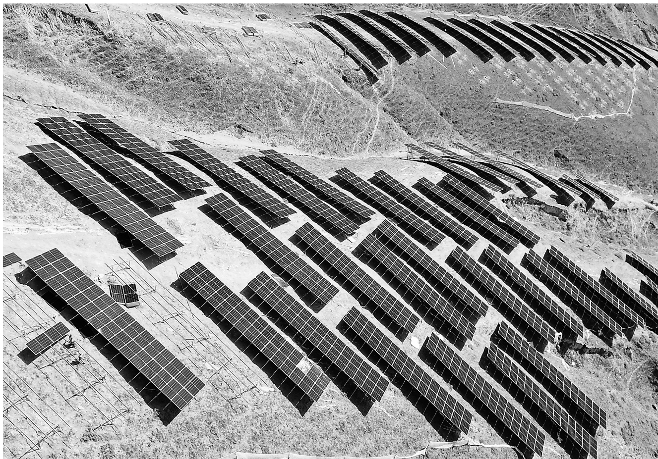
连日来，中电建东乡县200兆瓦光伏发电项目有序推进。据悉，该项目装机规模200兆瓦，同期建设一座330千伏升压站，预计今年年底竣工。
