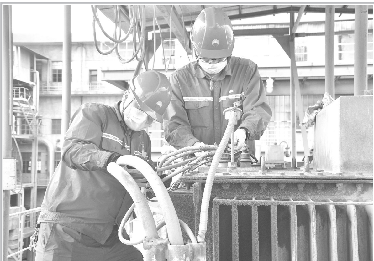
兰石化电仪事业部强化基础管理,定期开展要害区域设备的自查自纠,通过精细化管理实现降本增效。图为该事业部电气车间员工在清灰维护化肥厂动力车间A锅炉电场变压器。 崔自辉 摄
