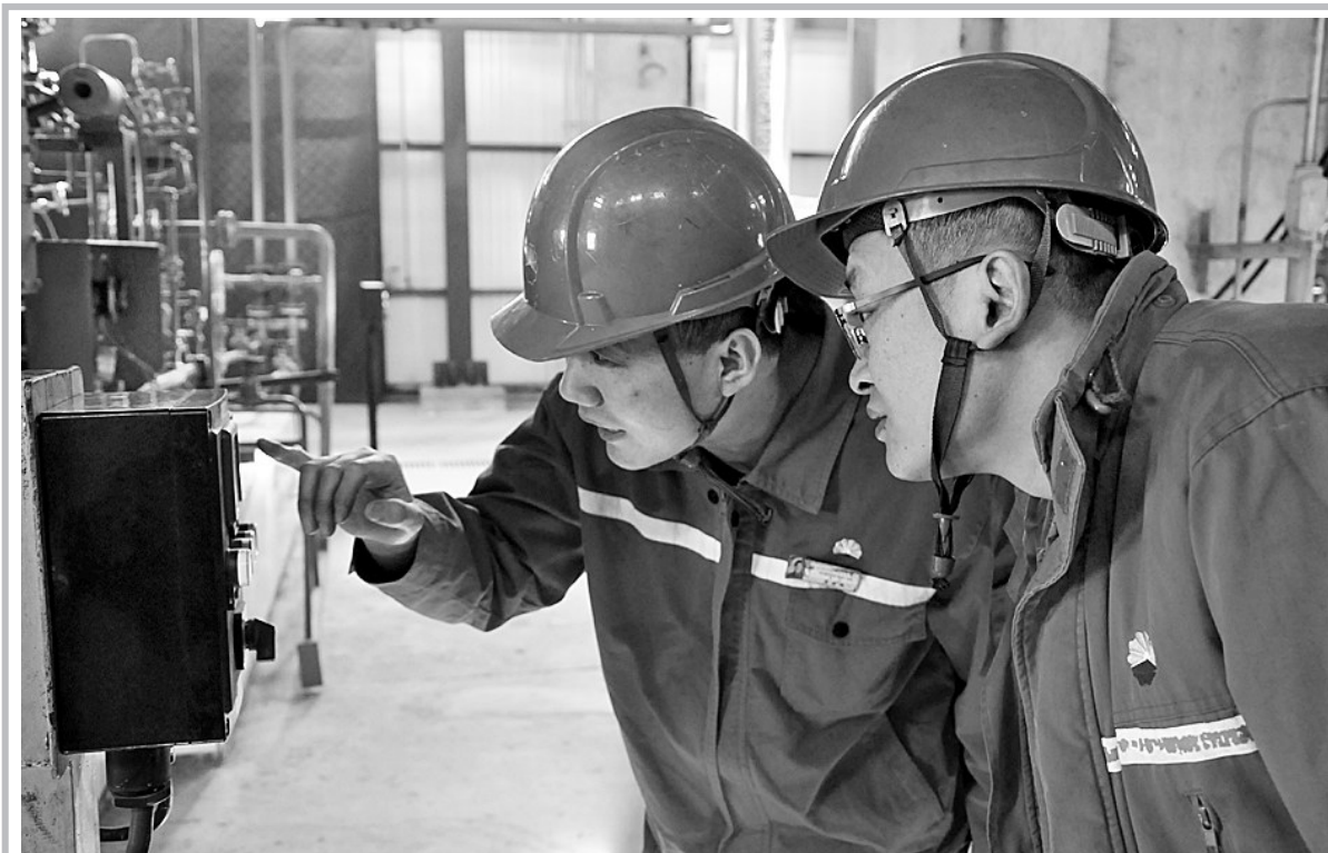
近日,兰州石化电仪事业部电气一车间技术员姜哲携“处方”,来到化肥厂动力车间煤运装置,对1号环锤破碎机隐患进行消缺。随着“药到”,“病根”得到有效根治。连日来,兰州石化采取强力手段,深入推进为期3个月的安全生产集中整治活动,整治安全隐患,严守安全红线。
