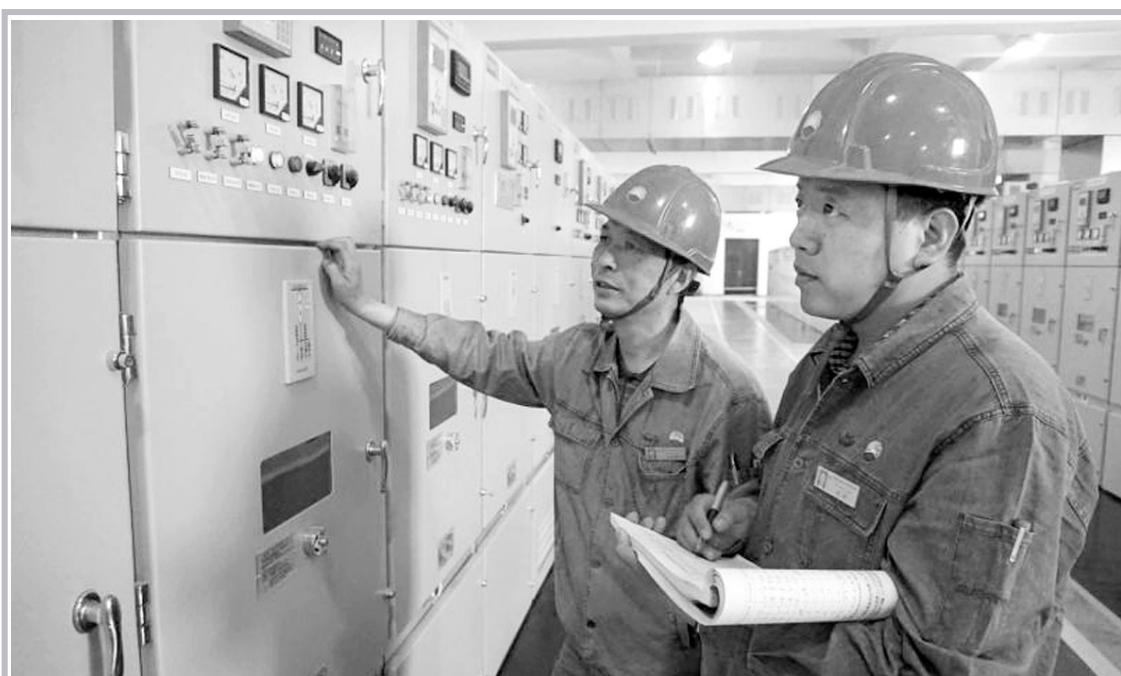
近来高温持续,影响炼化生产的供电设备正常运行,兰州石化动力厂电力系统的员工们积极应对,增开轴流风机给供电设备降温,并增加对重点供电设备的巡检频次,严格检查,发现异常,故障,及时采取措施排除不过夜,确保公司炼化生产装置电力平稳供应。图为电气系统员工正在仔细检查供电设备运行情况。 朱延州 摄
