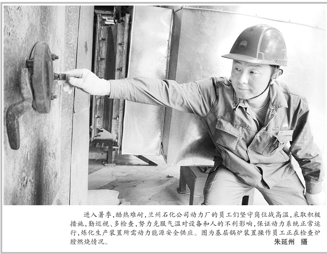
进入夏季,酷热难耐,兰州石化公司动力厂的员工们坚守岗位高温,采取积极措施,勤巡视、多检查,努力克服气温对设备和人的不利影响,保证动力系统正常运行,炼化生产装置所需动力能源安全供应。图为基层锅炉装置操作人员正在检查炉膛燃烧情况。朱延州 摄
