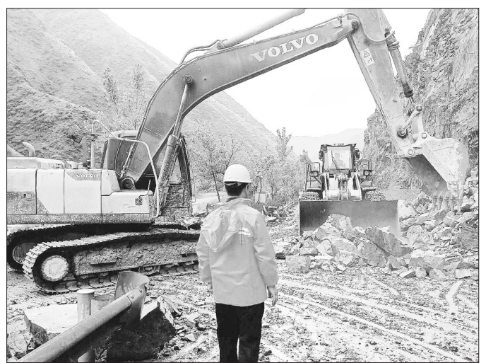
5月7日上午8时,S304线莲叶路K191+700米(天水市秦安县安伏镇陈家河村附近)发生山体塌方,致使交通中断。事发后,天水公路局组织秦安公路段投入人员、机械车辆赶赴现场紧急抢修。经过几个小时的奋战,该路段恢复畅通。(王晨昊 摄)
