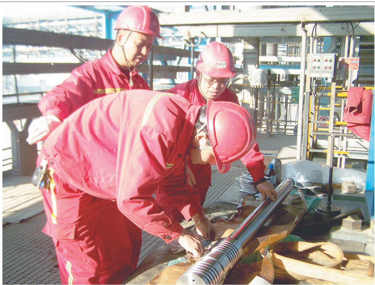
在中石油兰州石化公司持续开展的“鼓干劲、比贡献、创新高”专项活动中,兰州石化维达公司强化检修全过程管控,落实属地、施工、质量、安全等各项职责。图为该公司员工更换乙烯高压聚乙烯装置进口压缩机近2米长的活塞杆时,工程技术人员精心核对数据,确保检修的装配质量达标。
