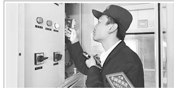
为不断提升车辆质量,连日来,兰铁兰州车辆段坚持按标检修,加强对车辆网联网、配电柜、车内设备、走行部、制动装置等进行全方位排查检修,严卡动态技检作业过程,确保运用列车设备达标。图为该段乘务员出库前检查配电柜。
