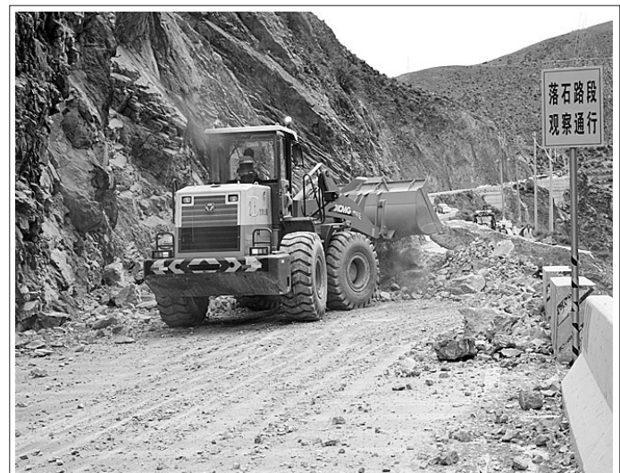
7月3日15时左右,迭部县九龙峡一处山体巨石坍塌,路面堆积物约273立方米,防撞墩墙损坏40余米,交通中断。迭部公路管理局、交警、路政、旺藏乡政府积极联动,及时启动应急预案,调动装载机2台,应急队员30人快速赶赴现场进行清理,16点30分恢复通行。侯向亮 摄
