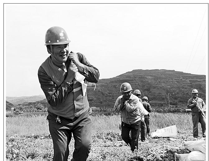
为保障突发洪水泥石流等紧急情况下对供电线路设备造成的损害,6月27日,平凉庄浪县供电公司临时调度3个供电所员工,开展防汛保供电工作演练。图为抢修人员抢修被洪水威胁的电杆。梁虹红 王续烈 摄
